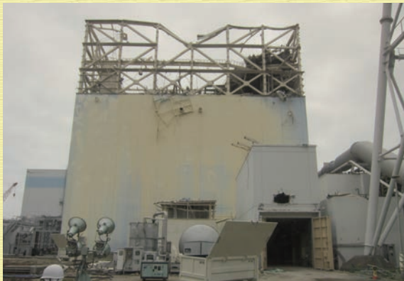
(左) 福島第一原子力発電所1号機 (平成24年6月18日 福島県災害対策本部撮影)
